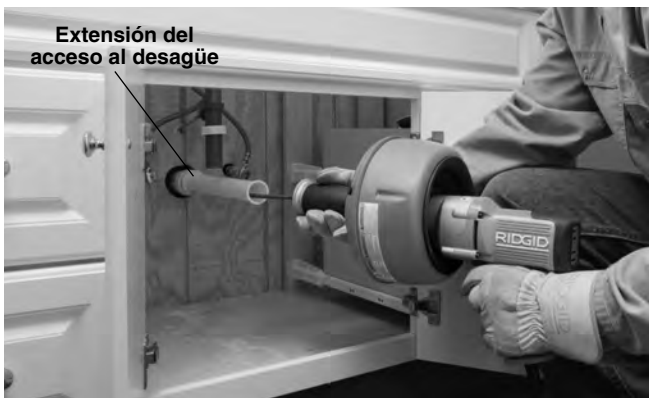
Figura 6 – Manera en que se alarga el desagüe para situar la nariz de la K-45 a menos de 15 cms. (6 pulgs.) del acceso
